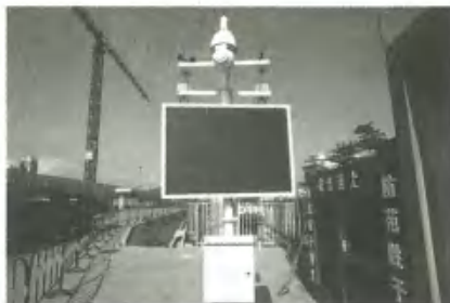
出入口 100% 安装 TSP 在线监测设备
