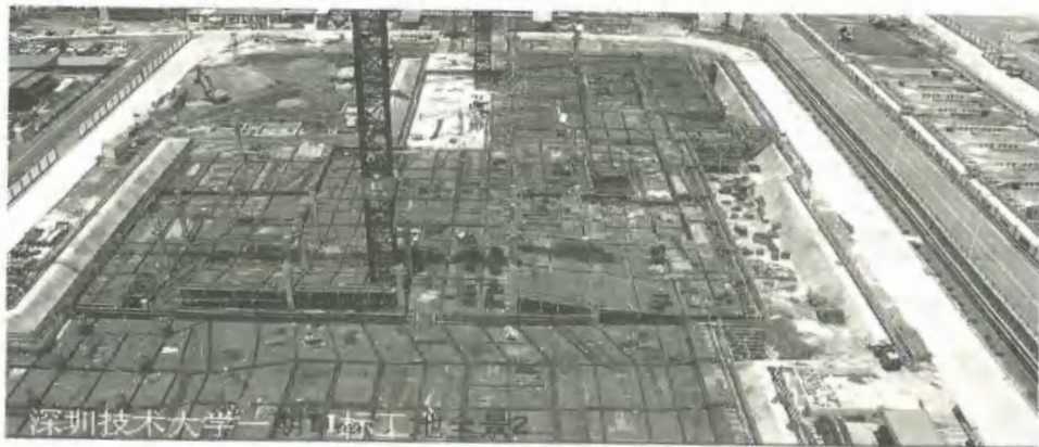
图 7 视频监控巡检图
